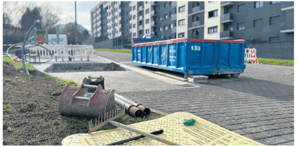
Aspecto de una de las obras que mejorará la zona de San Fausto.
